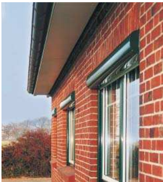
Formado Rundrollladensystem in der Laibung montiert
